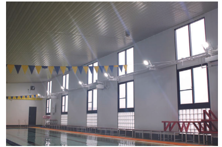
プール(屋内) 高天井LED【CR】
